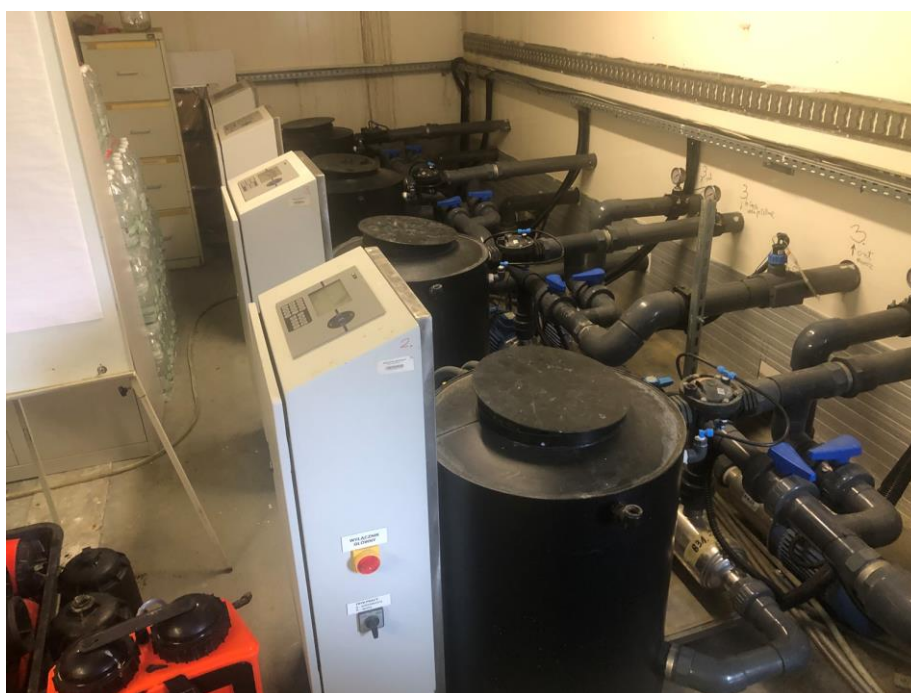
W budynku technicznym znajdują się dozowniki nawozów.
